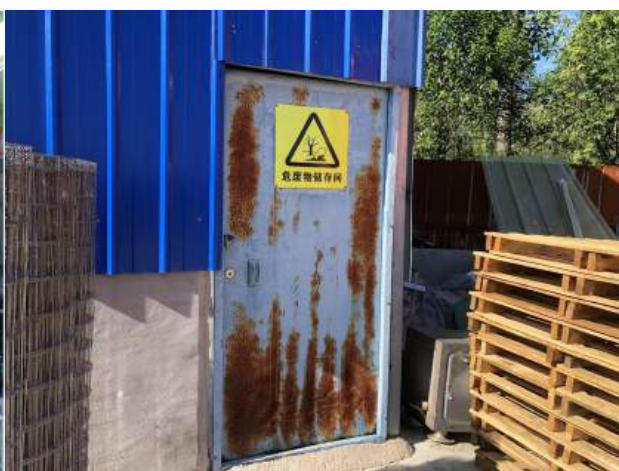
项目危废暂存间
